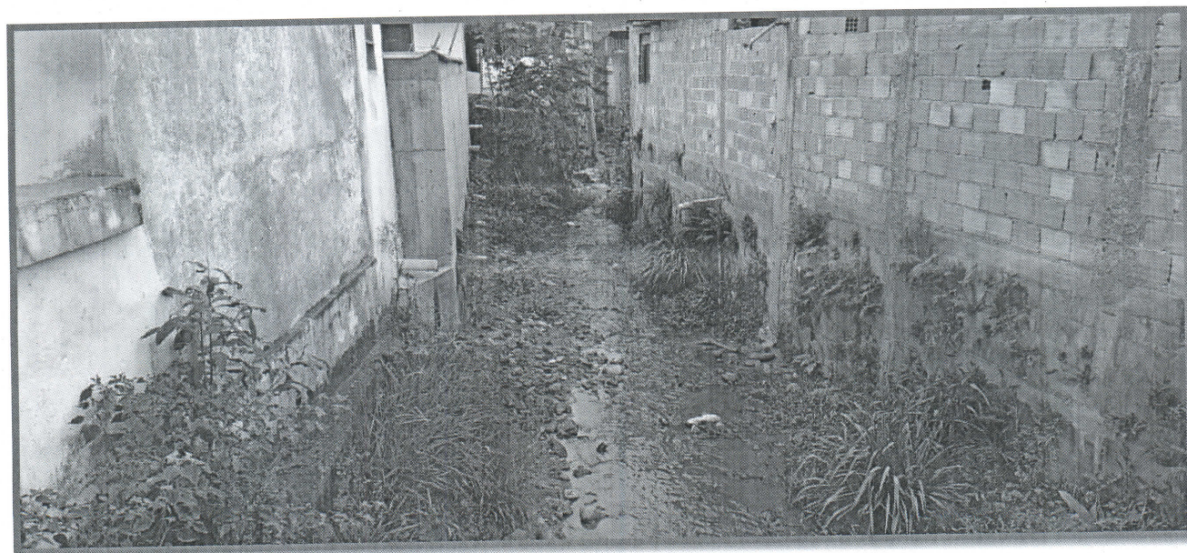
Leito do córrego obstruído por material sólido e vegetação, diminuindo a seção de fluxo da água. Detalhe: As construções estrangularam a seção do curso d'água.
