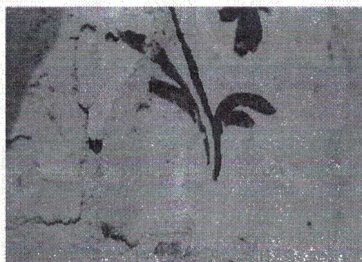
Figura 226: Detalhe desprendimento e perdas da camada pictórica Foto: ARAÚJO, Júnia. 01/07/2014.
