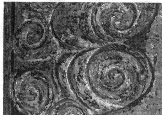
Figura 392 : Detalhe remoção inadequada da repintura
