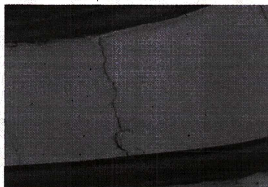
Figura 76: Detalhe de trinca
