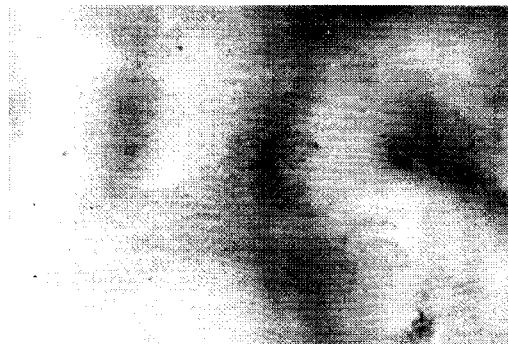
Figura 516 : Detalhe manchas escuras Foto: ARAÚJO, Júnia. 01/07/2014.
