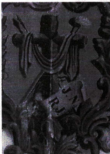
Figura 72: Detalhe das manchas Foto: ARAÚJO, Júnia. 01/07/2014.
