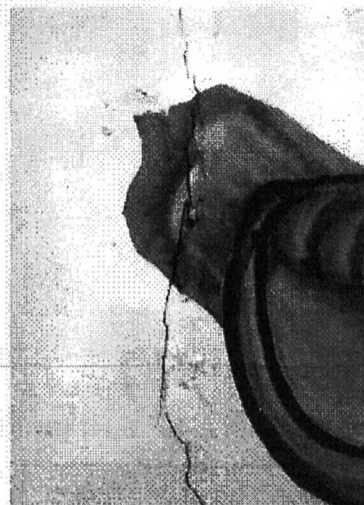
Figura 100: Detalhe da trinca Foto: ARAÚJO, Júnia. 01/07/2014.
