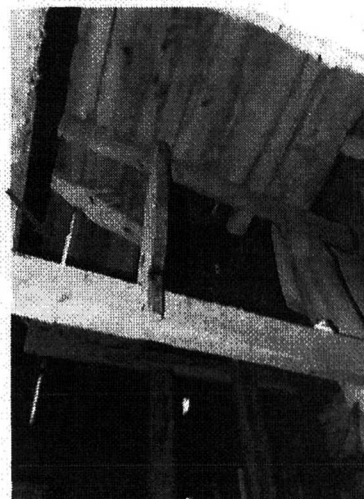
Figura 95: Deslocamento de blocos
