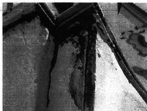
Figura 106: Detalhe da intervenção anterior Foto: ARAÚJO, Júnia. 01/07/2014.
