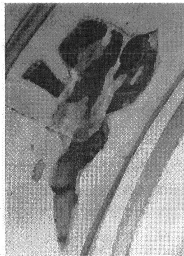
Figura 210: Pintura original com desprendimento e lacunas Foto: ARAÚJO, Júnia. 01/07/2014.
