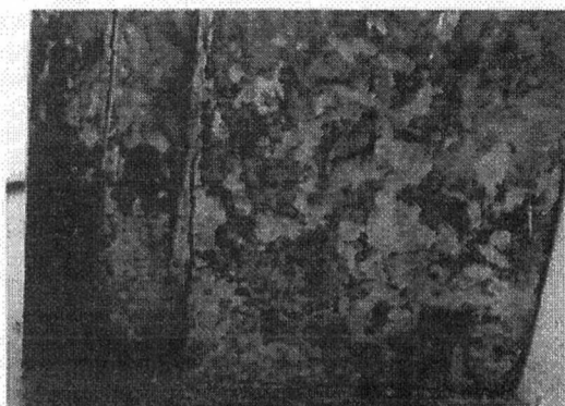
Figura 441 : Detalhe perda de suporte
