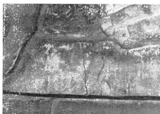
Figura 446 : Detalhe trinca Foto: ARAÚJO, Júnia. 01/07/2014.
