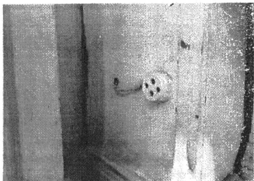
Figura 242 : Detalhe instalação elétrica Foto: ARAÚJO, Júnia. 01/07/2014.
