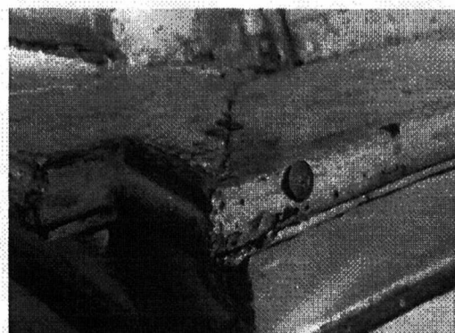
Figura 102: Detalhe da trinca Foto: ARAÚJO, Júnia. 01/07/2014.
