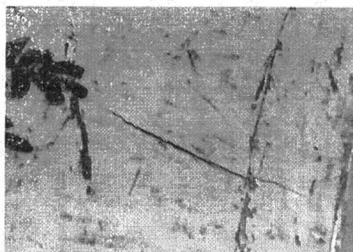
Figura 388 : Detalhe trinca Foto: ARAÚJO, Júnia. 01/07/2014.
