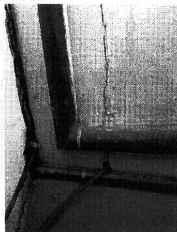
Figura 108: Detalhe da trinca e fiação Foto: ARAÚJO, Júnia. 01/07/2014.
