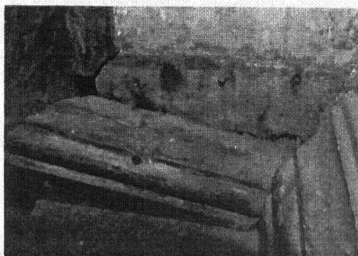
Figura 440 : Detalhe deslocamento de blocos
