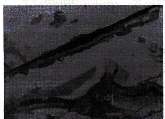
Figura 116: Tábua solta da estrutura Foto: ARAÚJO, Júnia. 01/07/2014.
