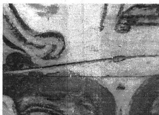
Figura 438 : Detalhe trinca causado por cravo
