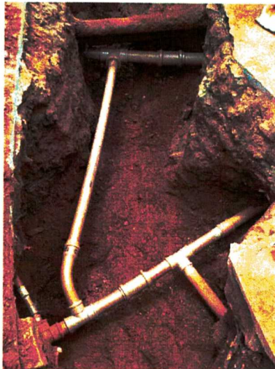
IMAGEM 04: INTERLIGAÇÃO DE REDE PARA GARANTIA DO ABASTECIMENTO DAS RESIDÊNCIAS ATENDIDAS PELO RESERVATÓRIO DA RUA JOSÉ ANASTÁCIO, BAIRRO PIEDADE (14/10/2021)
