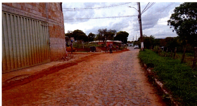
OBRAS DE REMANEJAMENTO DE REDE DE ÁGUA, RUA SANTA CRUZ, 351, GLAURA (OUT/2021)
