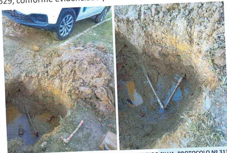
FIGURA 1. REPARO DE ÁGUA: RUA BURACO DE AREIA, RODRIGO SILVA. PROTOCOLO Nº 3133629.
