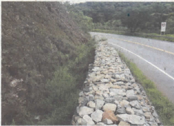
Foto 03: Espaço existente entre o muro gabião e o talude.
