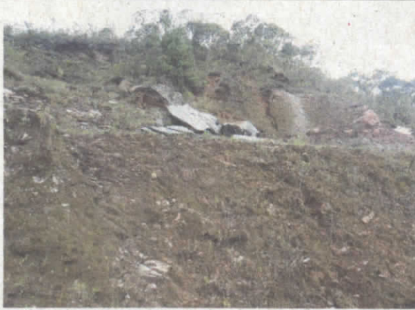
Foto 01: Rochas fragmentadas e acomodadas na banqueta do talude.
