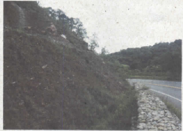
Foto 02: Situação do primeiro talude e do gabião no bordo da pista de rolamento.
