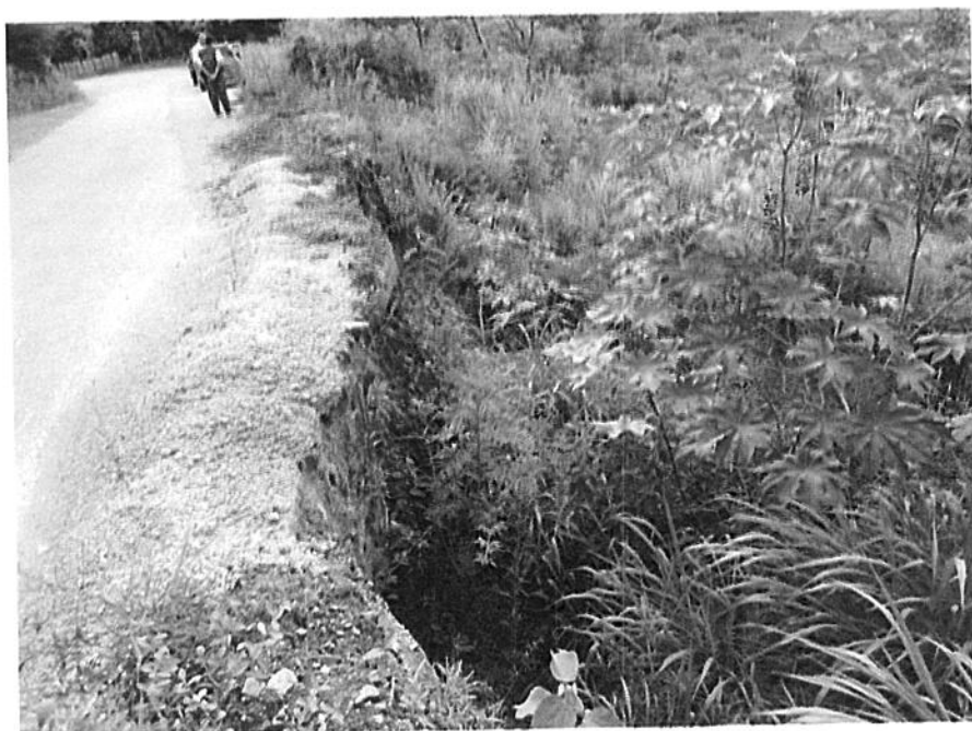
Figura 9 – Vista da pavimentação danificada.
