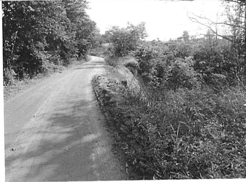
Figura 6 – Vista da pavimentação danificada. Possível acesso secundário a Glaura. Via não pavimentada
