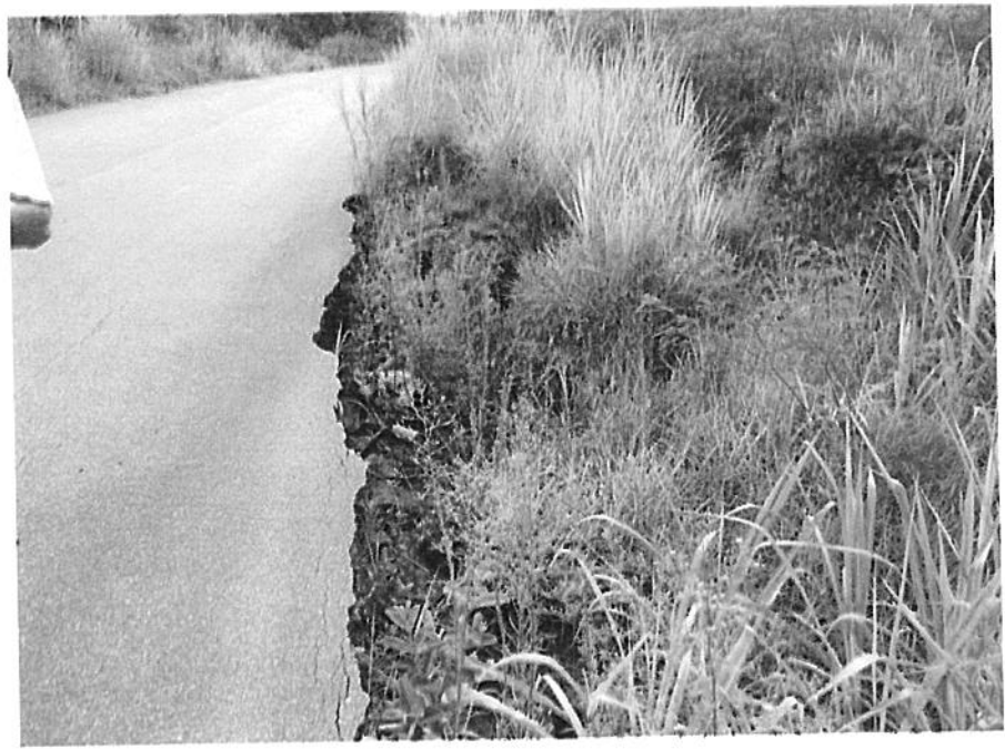
Figura 1 – Vista da pavimentação danificada.
