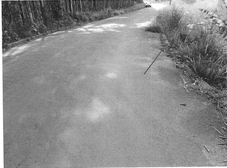
Figura 4 – Vista da pavimentação danificada. Acesso a Glaura e São Bartolomeu.
