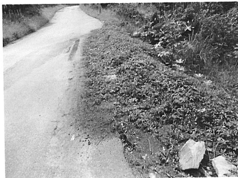
Figura 1 – Vista da pavimentação danificada. Acesso a Glaura e São Bartolomeu.
