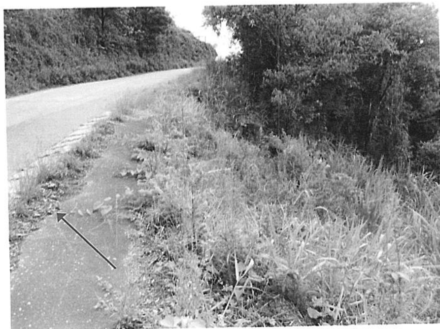
Figura 5 – Vista da pavimentação danificada. Detalhe da barreira colocada para impedimento da água.
