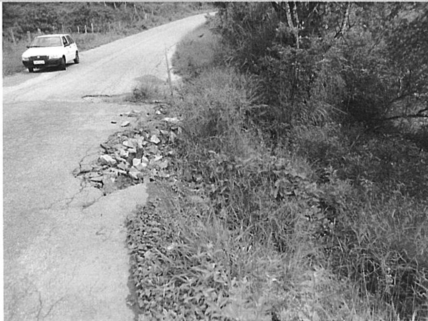
Figura 12 – Vista da pavimentação danificada
