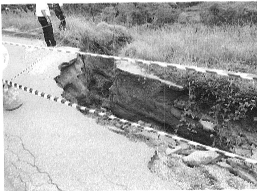
Figura 3 – Vista da pavimentação danificada.
