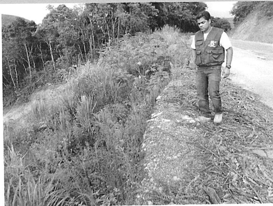
Figura 8 – Vista da pavimentação danificada. A rodovia teve sua largura aumentada para não comprometer o fluxo.
