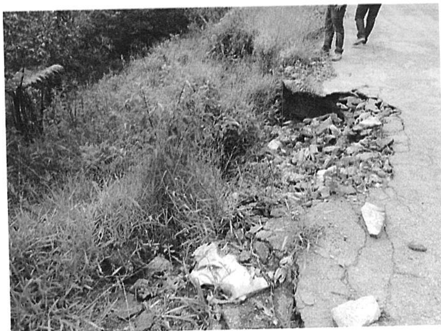
Figura 11 – Vista da pavimentação danificada.
