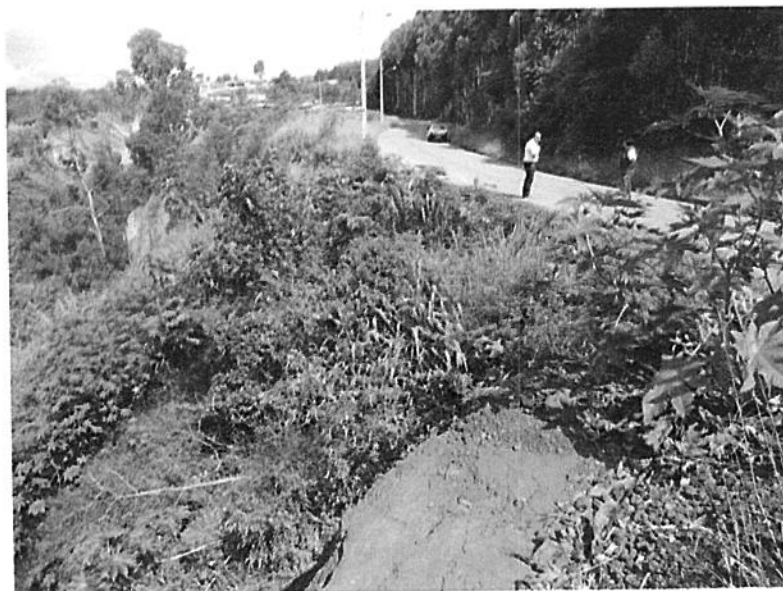
Figura 3 – Vista do talude onde houve movimentação de terra. Acesso a Glaura e São Bartolomeu.
