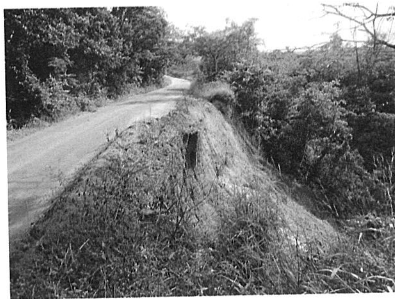
Figura 7 – Vista da pavimentação danificada. Possível acesso secundário a Glaura. Via não pavimentada
