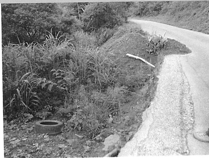
Figura 10 – Vista da pavimentação danificada.
