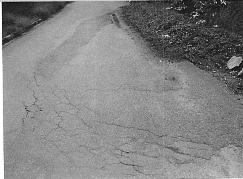
Figura 2 – Trincas na pavimentação indicando movimentação e comprometimento da mesma. Acesso a Glaura e São Bartolomeu.
