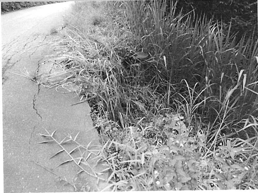
Figura 6 – Vista da pavimentação danificada.
