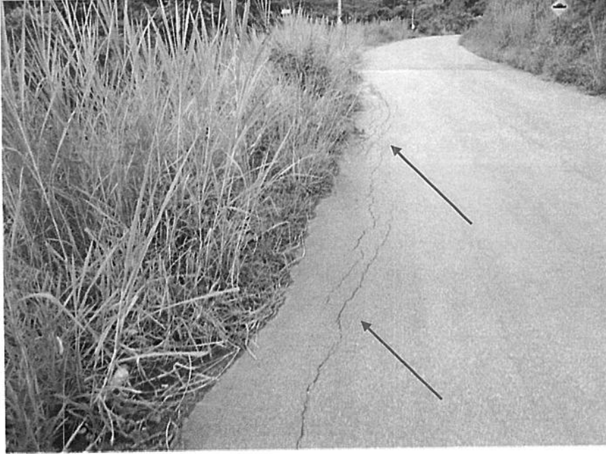
Figura 2 – Trinca na pavimentação indicando movimentação e comprometimento do mesmo.
