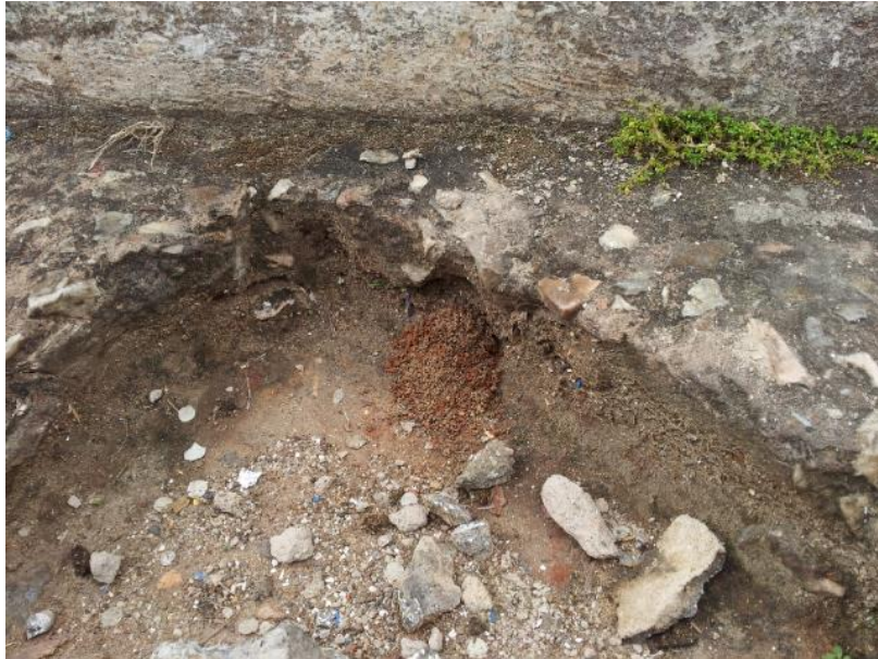
Foto 24 - Área 2 – Passeio Sul com falta de revestimento e presença de formigueiro. Autora da foto - Érika Gomes.
