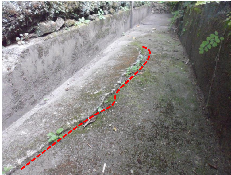
Foto 15 - Área 1 – Estufamento ao pé de muro de contenção. Autora da foto - Érika Gomes.
