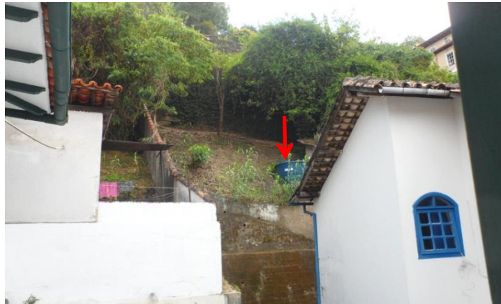
Foto 14 - Área 3 - Sobrecargas sobre o terreno. Autora da foto - Érika Gomes.
