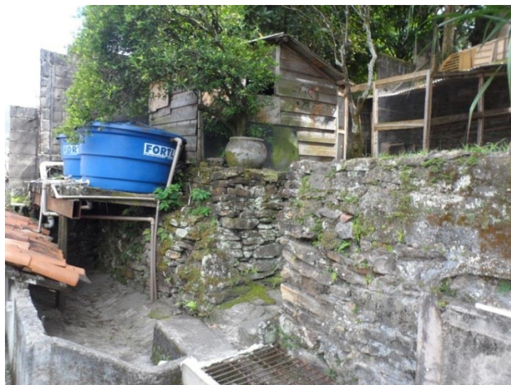
Foto 13 - Área 1 - Sobrecargas sobre o terreno. Autora da foto - Érika Gomes.
