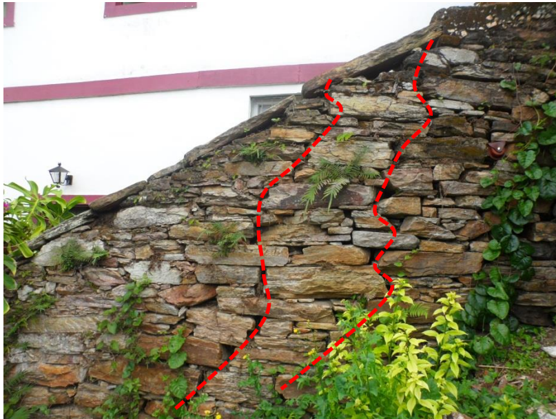
Foto 36 - Desalinhamento de pedras em face de muro de divisa. Autora da foto - Érika Gomes.
