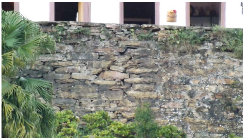
Foto 27 - Área 2 – Face do muro de contenção com diferença de textura de materiais e consequentemente, conceitos construtivos. Autora da foto - Érika Gomes.
