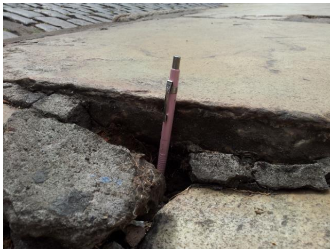
Foto 23 - Área 2 – Passeio Sul com abatimento entre placas de revestimento em pedra.
