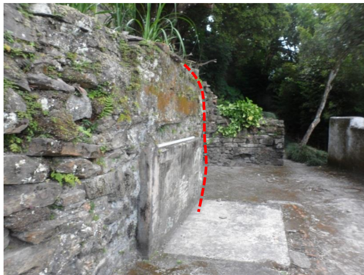
Foto 16 - Área 1 – Muro de contenção estufado. Autora da foto - Érika Gomes.
