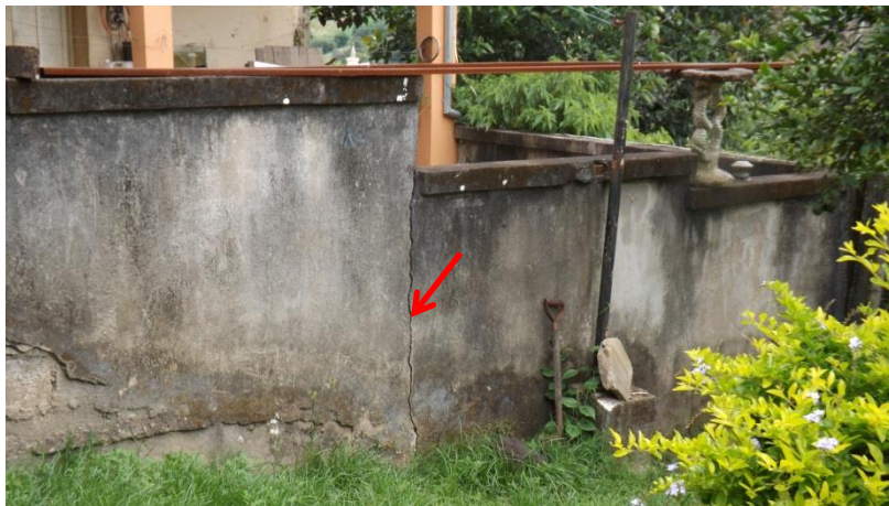
Foto 34 - Área 1 – Trinca em muro de divisa, em concreto. Autora da foto - Érika Gomes.
