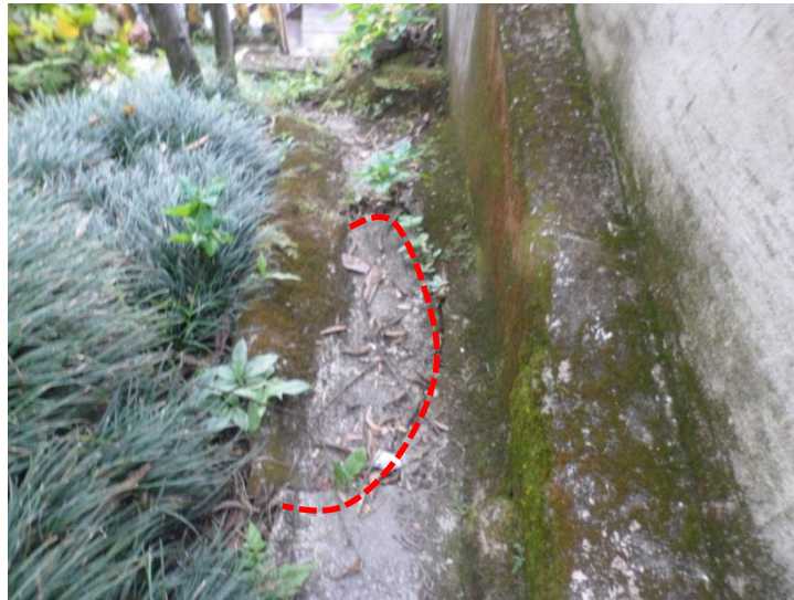
Foto 17 - Área 1 – Abatimento em canaleta de drenagem. Autora da foto - Érika Gomes.
