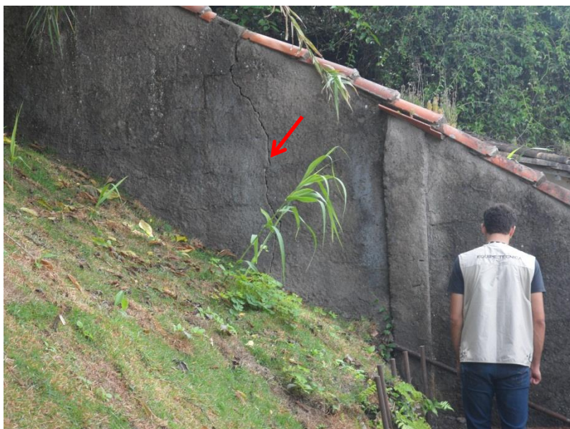
Foto 35 - Área 3 – Trinca em muro de divisa, em concreto. Autora da foto Júlia Lopes.
