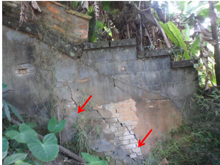
Foto 18 - Área 2 – Trinca em muro de divisa em alvenaria. Autora da foto - Érika Gomes.
