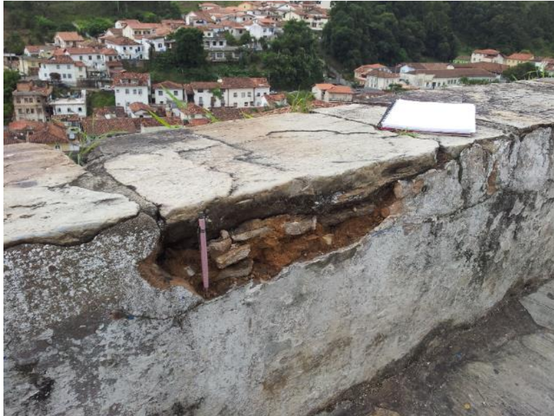
Foto 26 - Área 2 – Patologia em muro de contenção com deslocamento do revestimento de face. Autora da foto - Érika Gomes.
