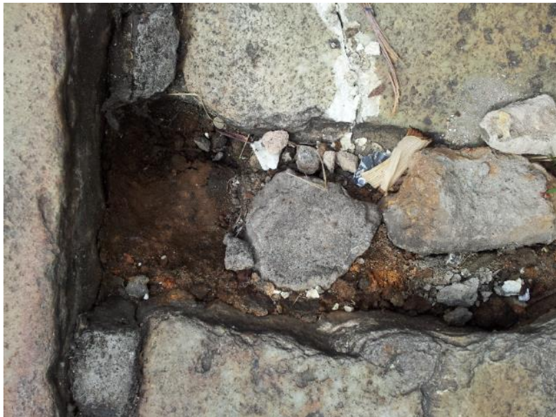
Foto 25 - Área 2 – Passeio Sul com buracos no revestimento e, conseqüentemente, pontos de empoçamento. Autora da foto - Érika Gomes.
