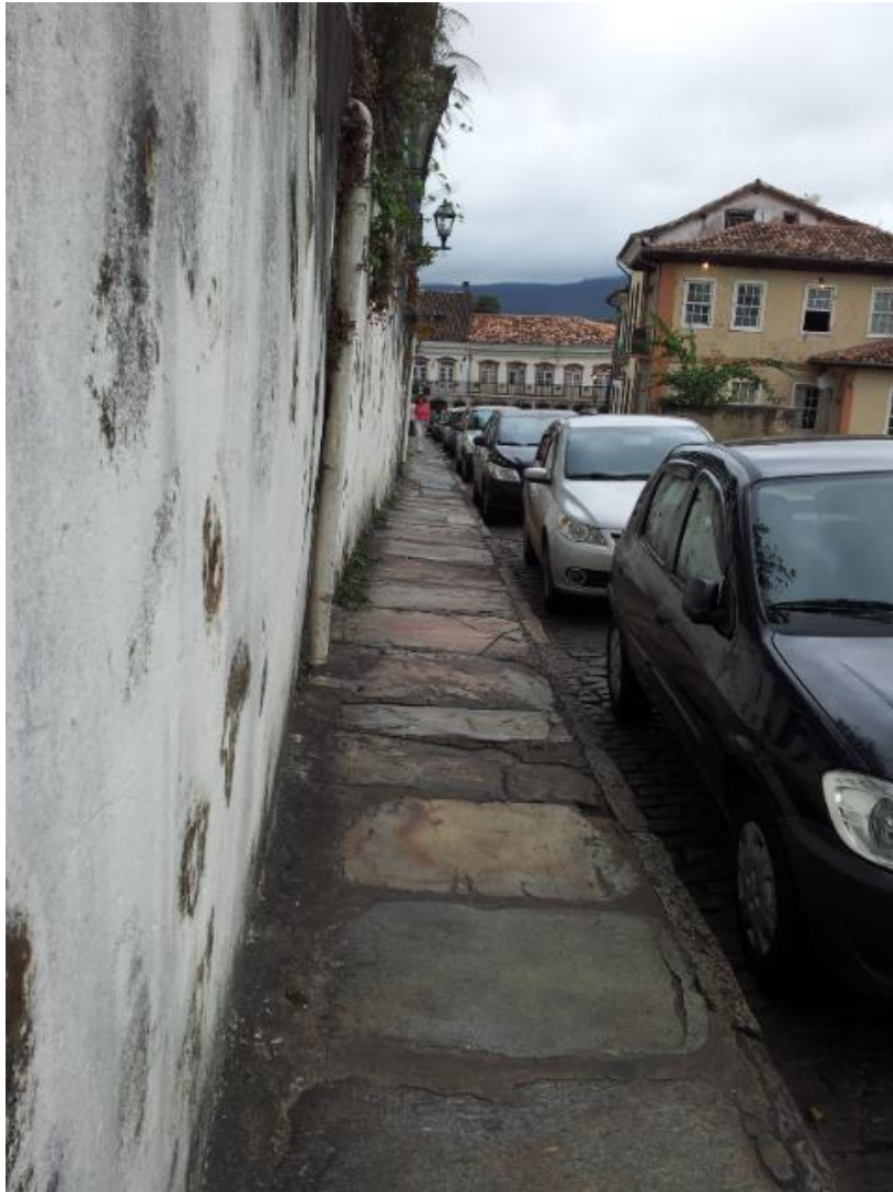
Foto 19 - Área 2 – Distorções em estrutura de contenção de pedra argamassada. Autora da foto - Érika Gomes.
