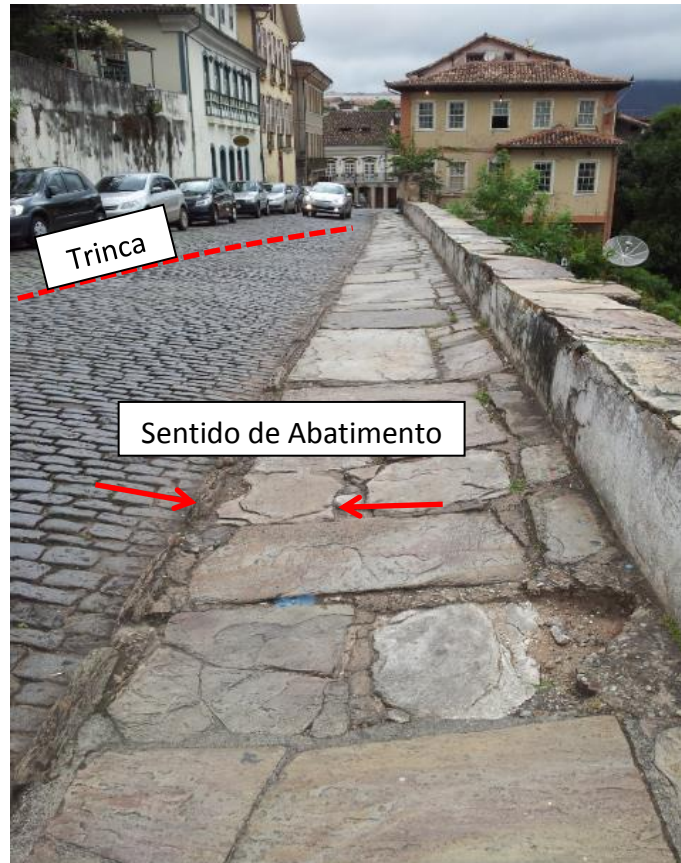
Foto 22 - Área 2 – Passeio Sul com problemas gerais que reforçam a caracterização do abatimento, além de problemas de manutenção que interferem no fluxo de águas superficiais. Autora da foto - Érika Gomes.
