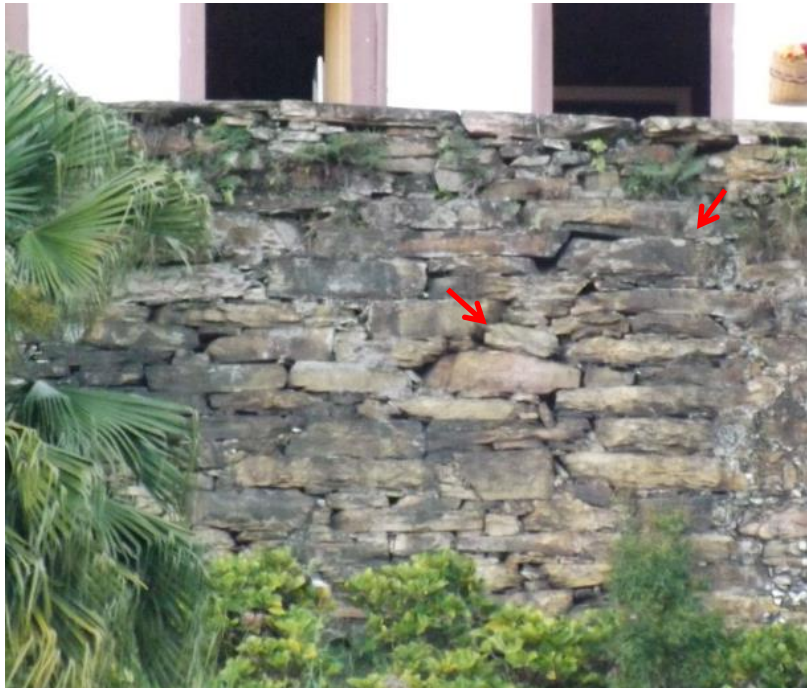
Foto 28 - Área 1 – Irregularidades no alinhamento de pedras em face de muro de contenção. Autora da foto - Érika Gomes.
