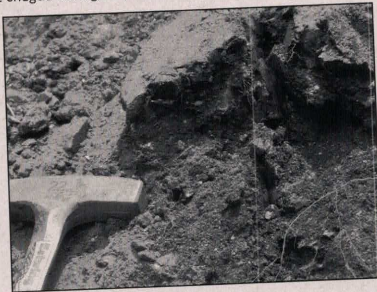
Foto 4.6 - Detalhe do aterro presente na base da escola Padre Carmélio. Notar a presença de pedregulhos médios de filito imersos na matriz arenosa fina.
