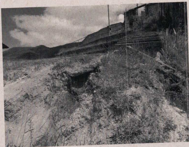
Foto 5.5 Detalhe da escada completamente avariada devido a processos erosivos promovidos, possivelmente, por problemas de drenagem.
