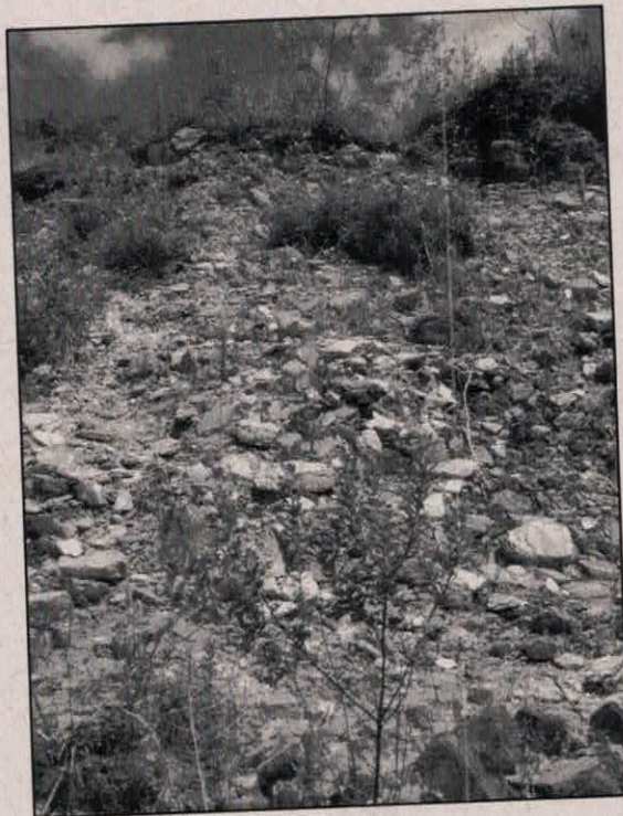
Foto 4.4- Vista geral para o núcleo de filito com resistência branda (R2-), grau de alteração alto (A4) e elevado grau de faturamento (F5).
