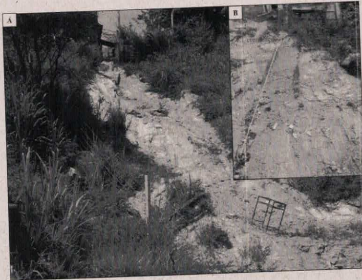
Foto 5.1- A) Vista geral do terço superior da encosta acometido por escorregamento planar. B) Detalhe da superfície de escorregamento condicionada pelo plano da foliação no filito. A linha amarela exhibe descontinuidade paralela ao plano da clivagem de crenulação que, por vezes, pode condicionar a liberação lateral da massa rochosa na forma de cunhas.
