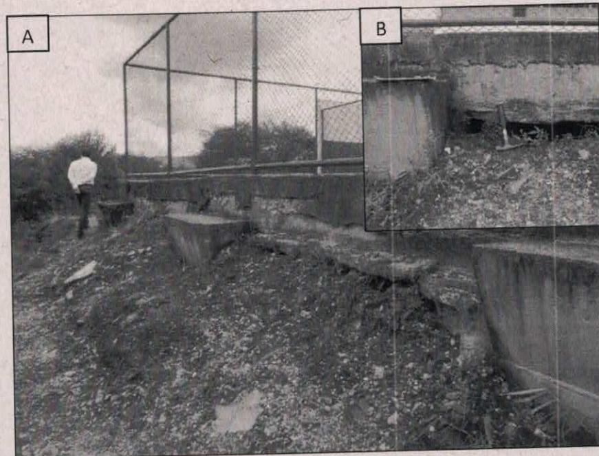
Figura 1.3 - A) Vista geral para o recalque do aterro situado na porção sul da escola. B) Detalhe do vão criado entre o piso da quadra de esportes e o maciço de aterro devido ao recalque deste.
