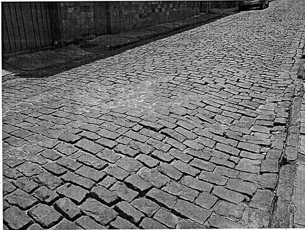
Foto 04 – deformação do pavimento
