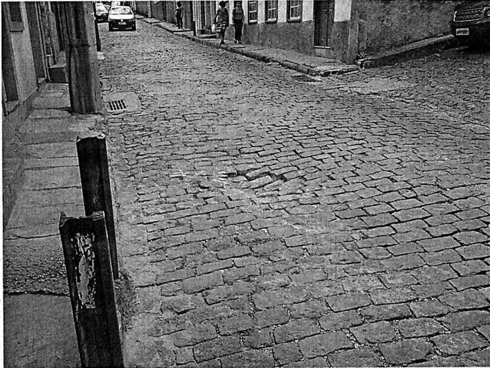
Foto 08 – afundamento do pavimento
