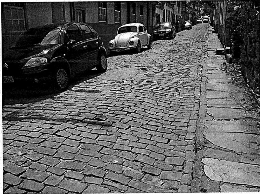
Foto/02 – deformação do pavimento
