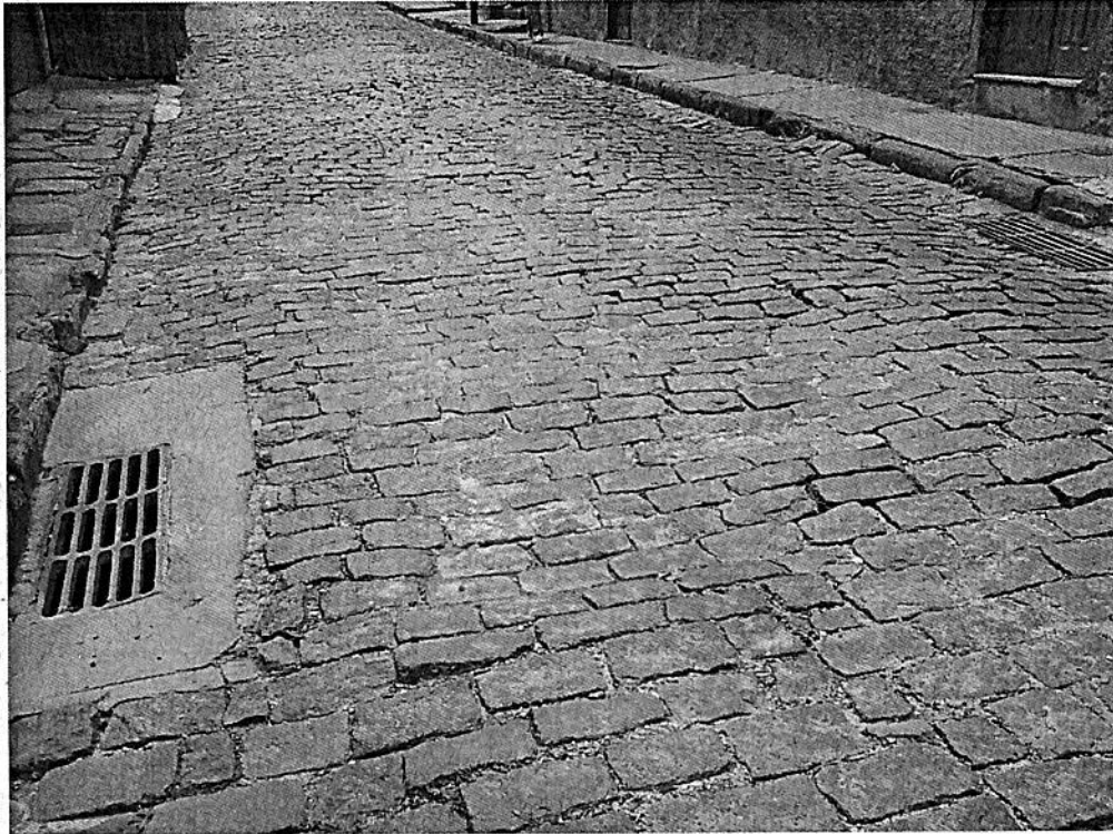
Foto 10 – deformação do pavimento
