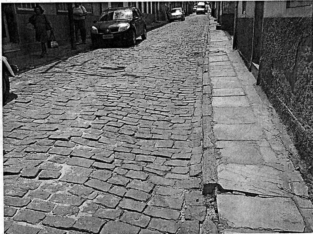
Foto 03 – deformação do pavimento
