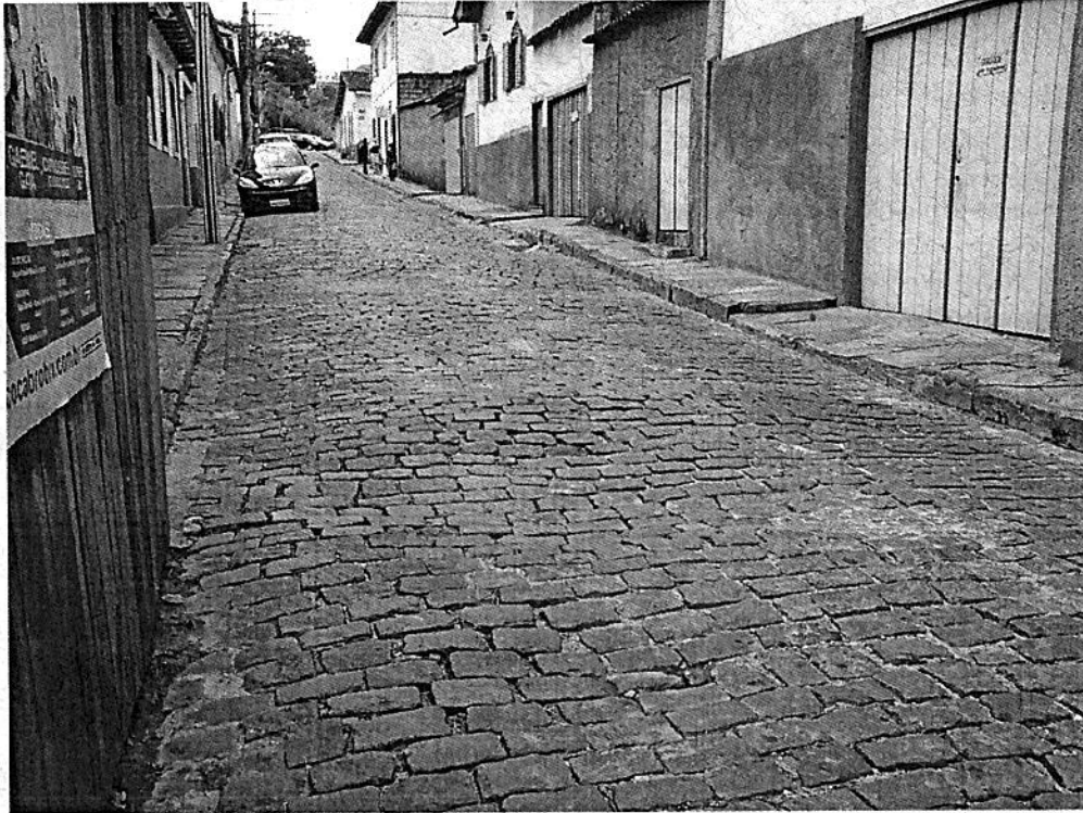
Foto 12 – deformação do pavimento
