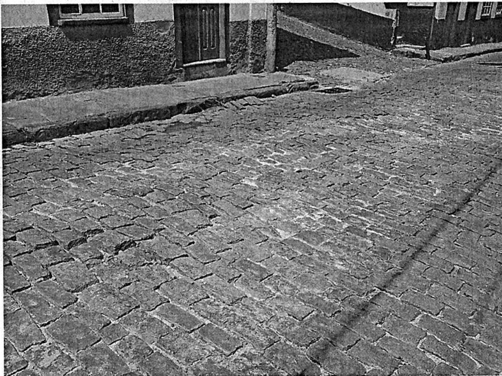
Foto 11 – deformação do pavimento
