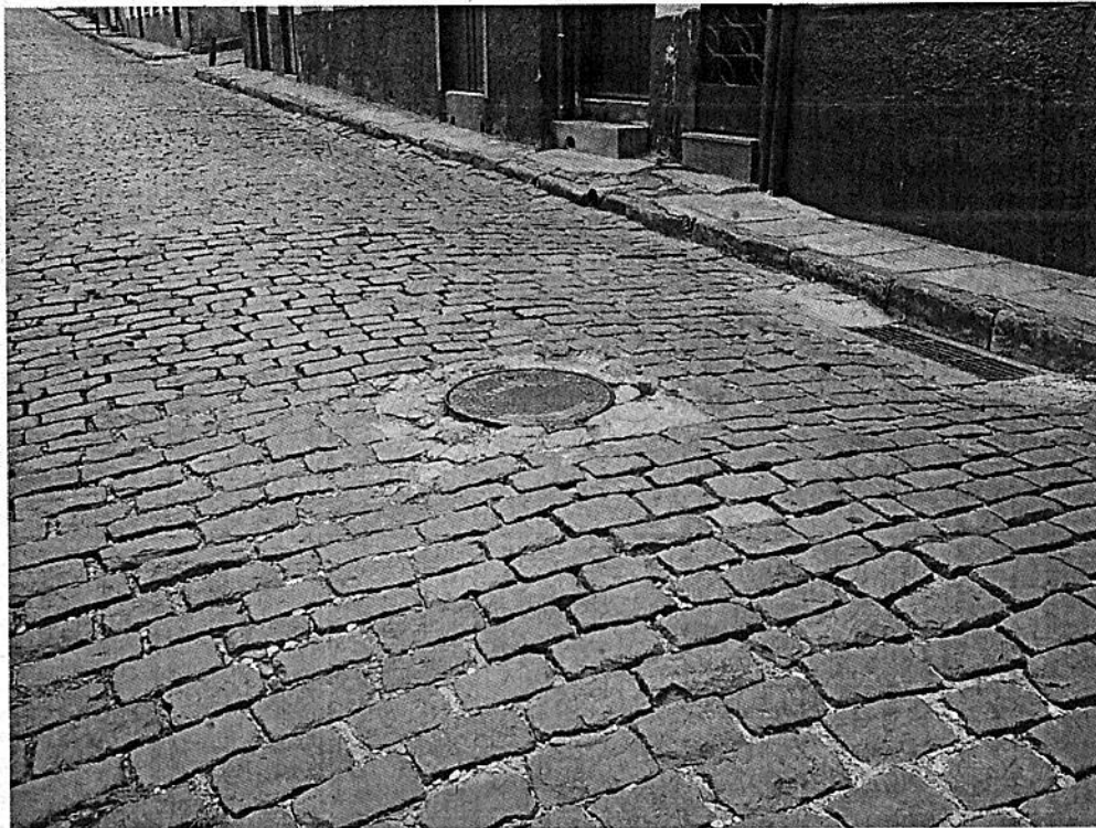
Foto 06 – quebra de tampa em concreto
