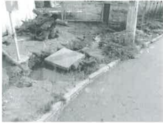
Fotos 09: Refluxo da tubulação
