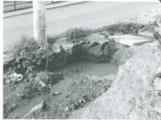
Foto 10: Poste em risco
