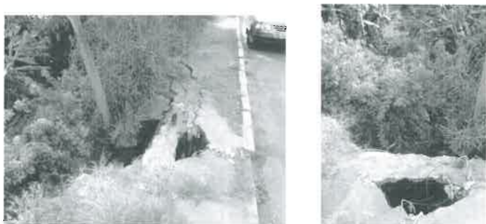
Fotos 07 e 08: Comprometimento do passeio e rompimento do talude
