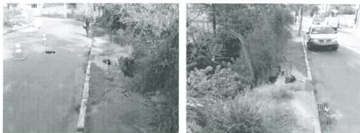
Fotos 06 e 07: Buraco na pista, rompimento de talude e comprometimento do passeio
