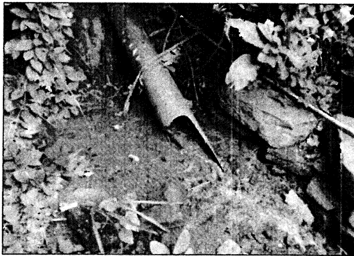
Foto 7 – Detalhe para a tubulação de esgoto rompida.
