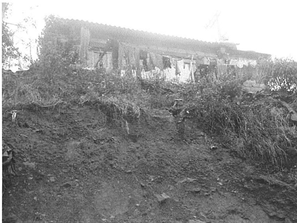
Construção precária em área de deslizamento (foto 03)
