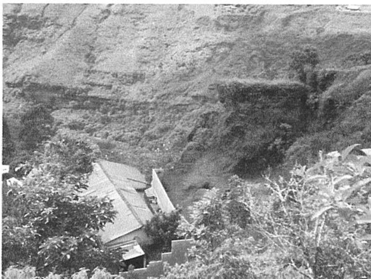
Corte recente do talude, pedra de canga "descalçada" com iminência de queda
