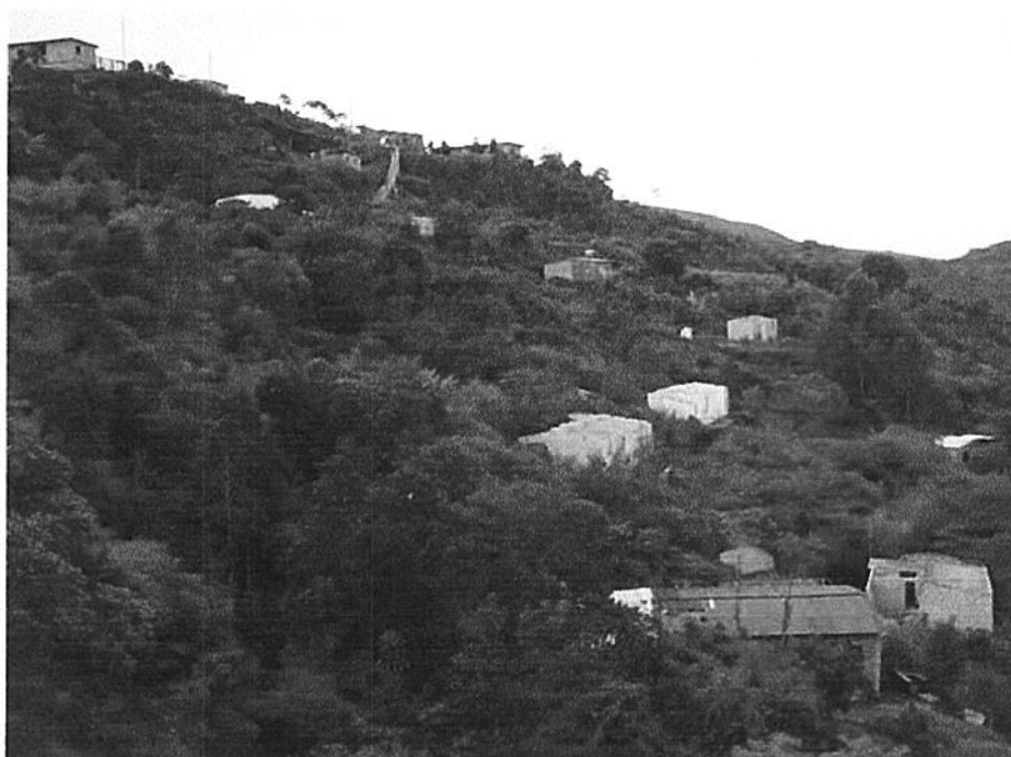
Vista geral da área (destaque para demolição de residências de famílias já removidas)
