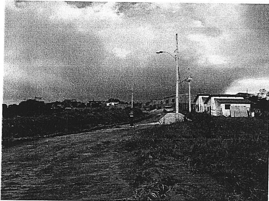
Vista da abertura das valas para rede de esgotamento sanitário e drenagem pluvial (foto 01)
