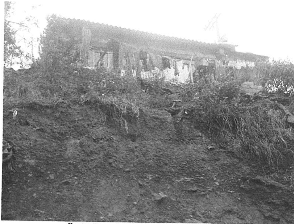
Construção precária em área de deslizamento (foto 03)
