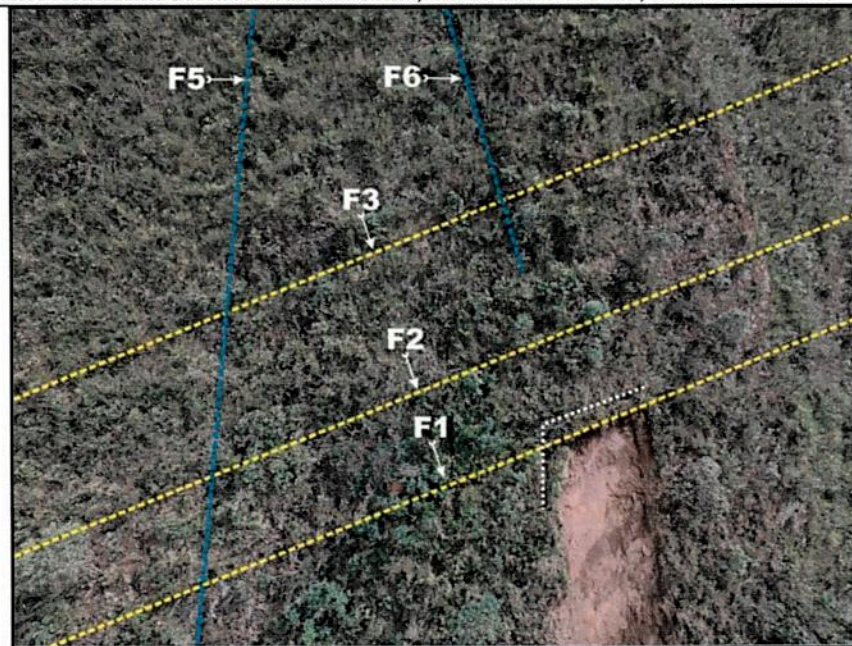
Figura 19 – Mesma foto anterior com indicação das principais fraturas abertas identificadas, indicando o alto risco geotécnico de ocorrência de novas rupturas planares por deslocamentos do Itabirito. Note que imediatamente acima da ruptura existe ainda um pequeno volume de material pendente que deverá ser removido. Autor: Charles Romazâmu Murta. Local: Rua Pirita, Bairro São Cristóvão; Data: 13/01/2018.
