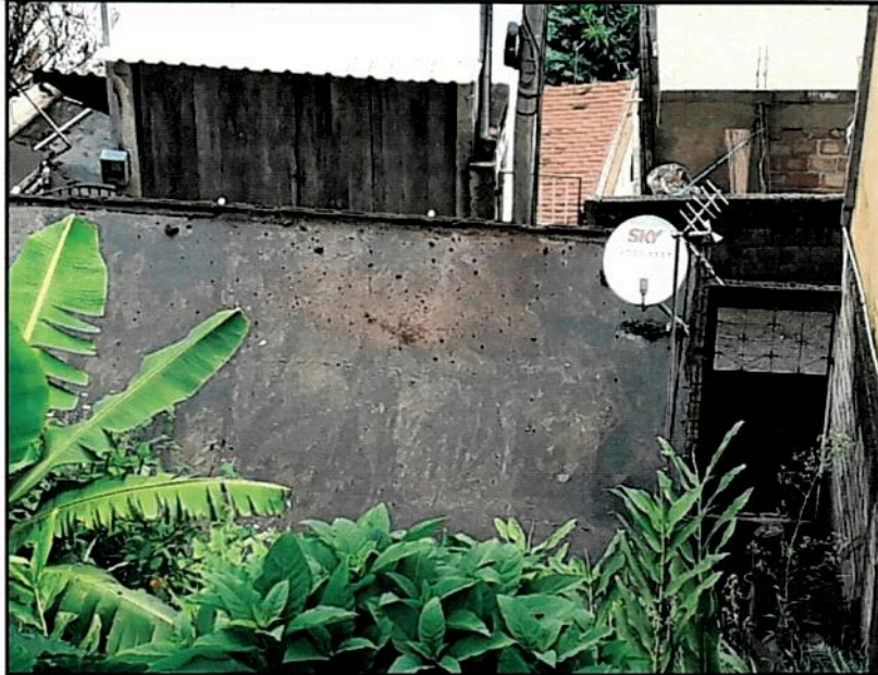
Figura 16 – O bloco de canga citado na foto anterior, atingiu a laje da casa do Srº Claudinei Nascimento na rua Abelardo Braga, nº 252, marcando o final da zona de espraçamento do material mobilizado durante o deslizamento. Autor: Charles Romazâmu Murta. Local: Rua Pirita, Bairro São Cristóvão; Data: 06/01/2018.
