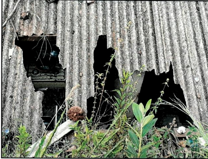
Figura 12 – Visão superior da cozinha da residência do Sr. João Gualberto Cândido com o telhado parcialmente destruído após ter sido atingido pelos blocos de canga durante o movimento de massa planar. Não há distância de separação entre a encosta e a residência, aumentando expressivamente o risco geotécnico local. Essa atitude dos moradores é comum na área analisada. Autor: Charles Romazâmu Murta. Local: Rua Pirita, Bairro São Cristóvão; Data: 06/01/2018.
