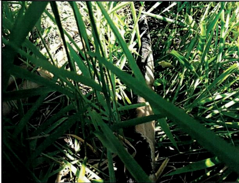
Figura 10 – A tubulação da adutora que alimenta a caixa d'água por bombeamento passa de forma aérea sobre o aqueduto na área estudada. Dessa forma, a mesma fica exposta a ações como vandalismo, ressecamento e queimadas como as que ocorreram nos meses de agosto e setembro do ano de 2017. A foto mostra a tubulação queimada durante um grande incêndio na encosta. Ressalta-se a necessidade urgente do SEMAE em aumentar a segurança dessa rede no local, visto que os riscos geotécnicos locais são elevados e a água é o principal agente deflagrador dos movimentos planares como o que ocorreu recentemente. Autor: Charles Romazâmu Murta. Local: Rua Pirita, Bairro São Cristóvão; Data: 06/01/2018.
