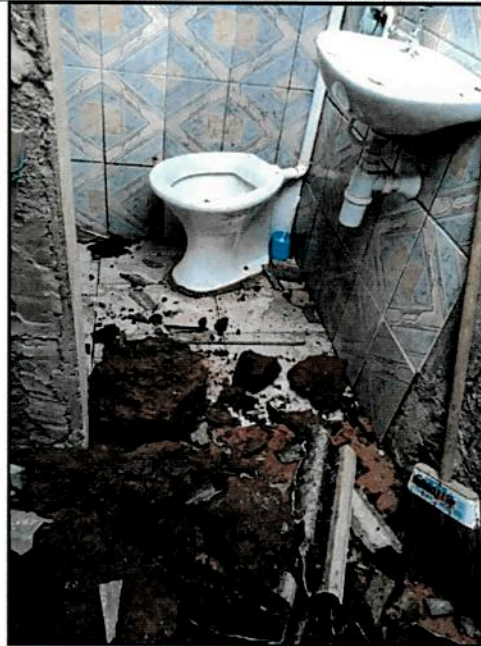
Figura 13 – Visão do banheiro lateral à cozinha da residência do Sr. João Gualberto Cândido que teve o telhado destruído após ter sido atingido pelos blocos de canga durante o movimento de massa planar. Autor: Charles Romazâmu Murta. Local: Rua Pirita, Bairro São Cristóvão; Data: 06/01/2018.
