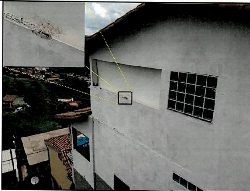
Figura 15 – A fim de evidenciar a elevada energia cinética que os blocos ganharam durante o movimento, um destes blocos saltou sobre a Rua Perita, atingiu a alvenaria da residência da Srª Welersan Rodrigues e se defletiu sentido a rua Abelardo Braga abaixo. Autor: Charles Romazâmu Murta. Local: Rua Pirita, Bairro São Cristóvão; Data: 06/01/2018.
