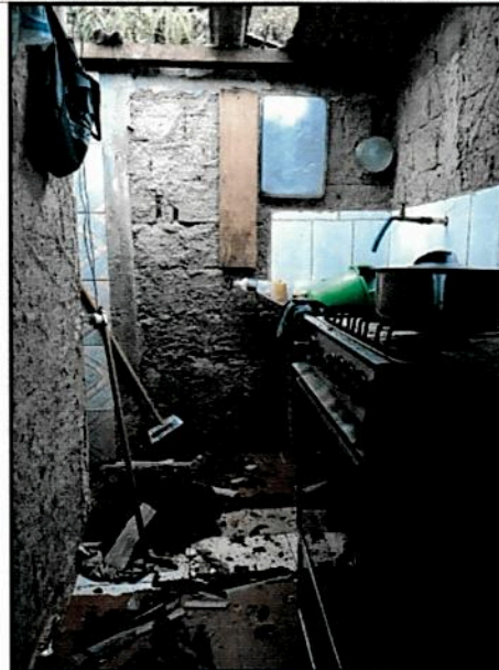
Figura 11 – Visão da cozinha da residência do Sr. João Gualberto Cândido com o telhado parcialmente destruído após ter sido atingido pelos blocos de canga durante o movimento de massa planar. Autor: Charles Romazâmu Murta. Local: Rua Pirita, Bairro São Cristóvão; Data: 06/01/2018.
