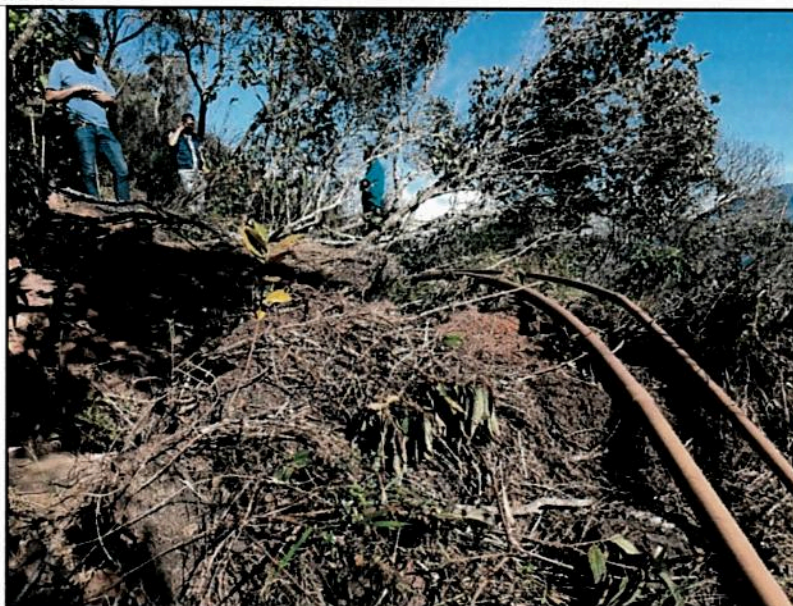
Figura 9 – Visão das placas de Itabirito que ficaram retidas no aqueduto e também da adutora, já reparada, que foi rompida pelo movimento de massa planar. Com o rompimento da adutora, grande volume de água foi lançado na encosta que já se encontrava saturada pelas chuvas anteriores. Dessa forma, o processo foi acelerado e o material à jusante ganhou mobilidade transportando também os blocos de canga que compunham a estrutura do aqueduto. Os técnicos do SEMAE deverão verificar a segurança das conexões que foram realizadas. Autor: Charles Romazâmu Murta. Local: Rua Pirita, Bairro São Cristóvão; Data: 06/01/2018.
