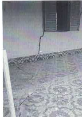
FIGURA 4: Trincas cisalhantes do piso ao teto. Parte frontal da residência, com grandes
