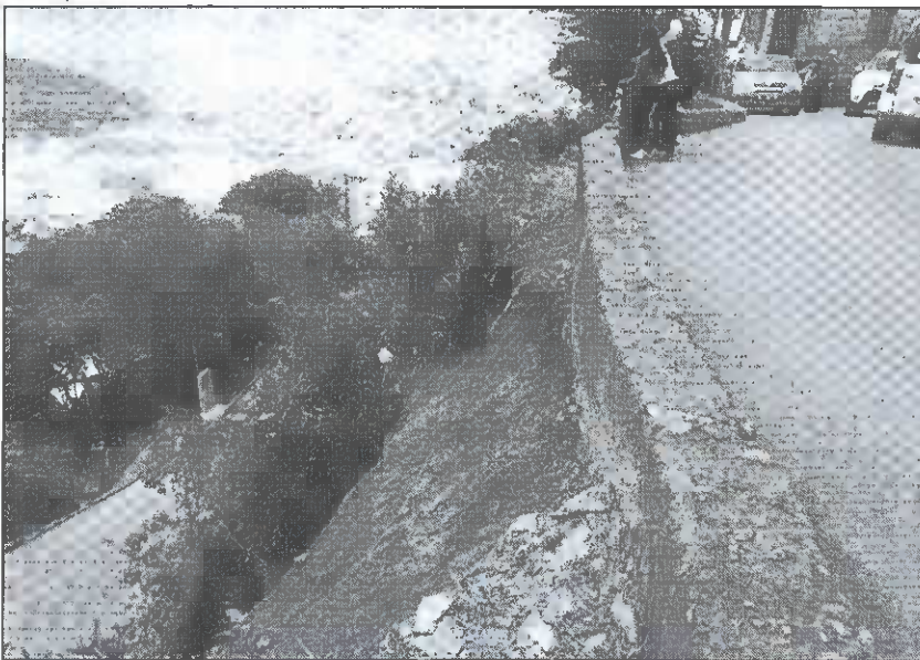
Figura 8 – Foto lateral mostrando o alcance do deslizamento que coloca em risco a Rua Nossa Senhora das Graças com grande trânsito de veículos e pedestres por ser um acesso estratégico para centenas de moradores do Bairro Morro da Queimada. Uma estruturação desse trecho da via se faz urgente e necessária. Autor: Charles Romazâmu Murta. Local: Rua Nossa Senhora das Graças; Bairro Morro da Queimada; Data: 12/11/2018.
