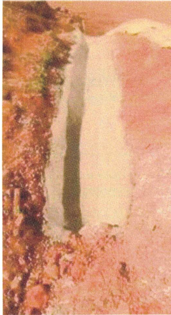
Figura 4.16 - Drenagem próxima ao acesso da berma intermediária do talude de jusante constituída por uma canaleta trapezoidal.
