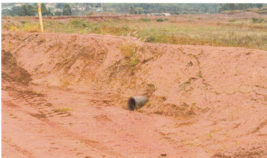
Figura 4.2 – Drenagem do coroamento da barragem Auxiliar do Vigia por meio de tubulação em PEAD.
