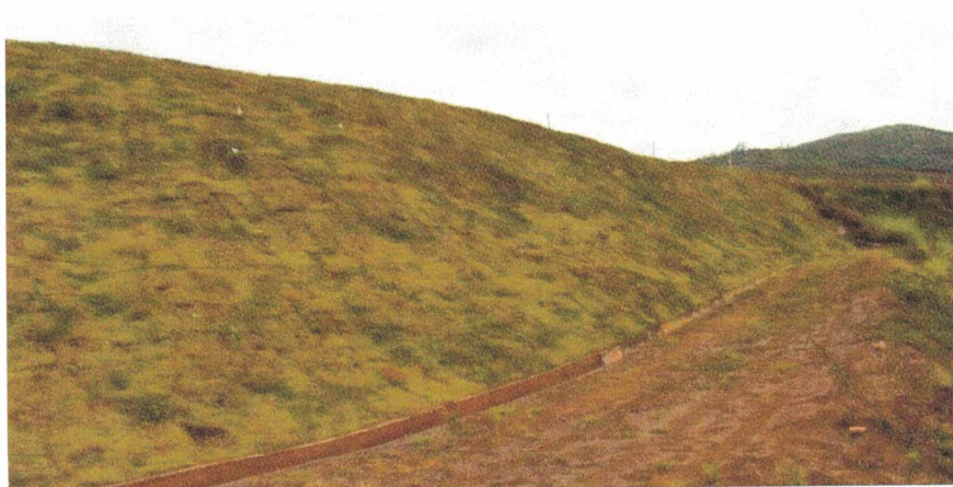
Figura 4.4 – Vista frontal do talude jusante da barragem Auxiliar do Vigia com destaque para a existência de revestimento vegetal efetivo
