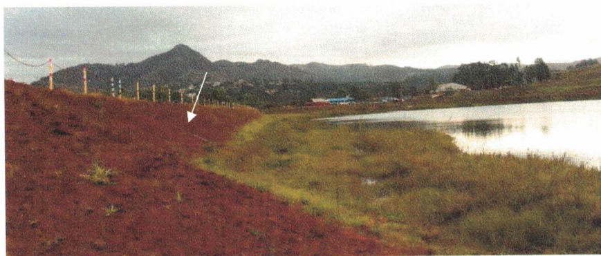
Figura 4.2 – Vista do talude de montante com destaque os dispositivos de drenagem superficial em PEAD
