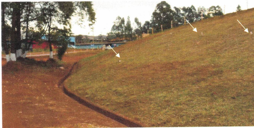
Figura 4.4 – Vista lateral do talude de jusante sob a crista da barragem. Destaque para presença de cupins e/ou formigueiros, já identificados pela CSN, sendo necessário realizar dedetização.
