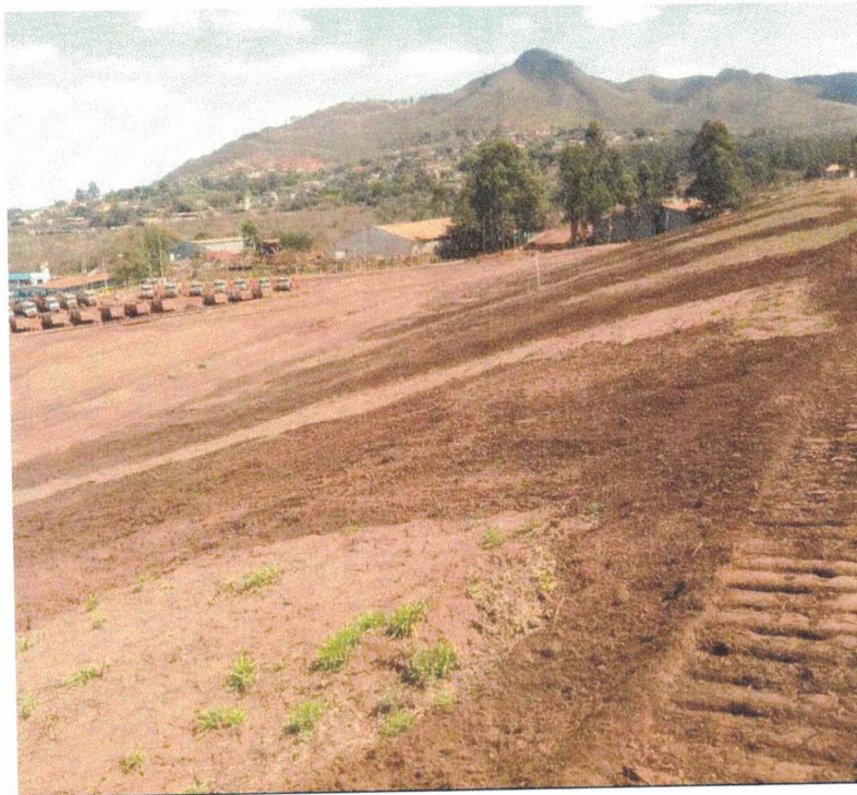
Figura 4.7 – Talude de jusante da Pilha 01, com revestimento vegetal deficiente e erosões sendo tratadas.
