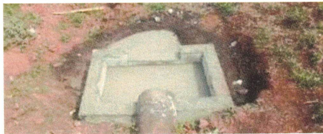
Figura 4.17 - Tubulação de PEAD que desagua numa caixa de dissipação.
