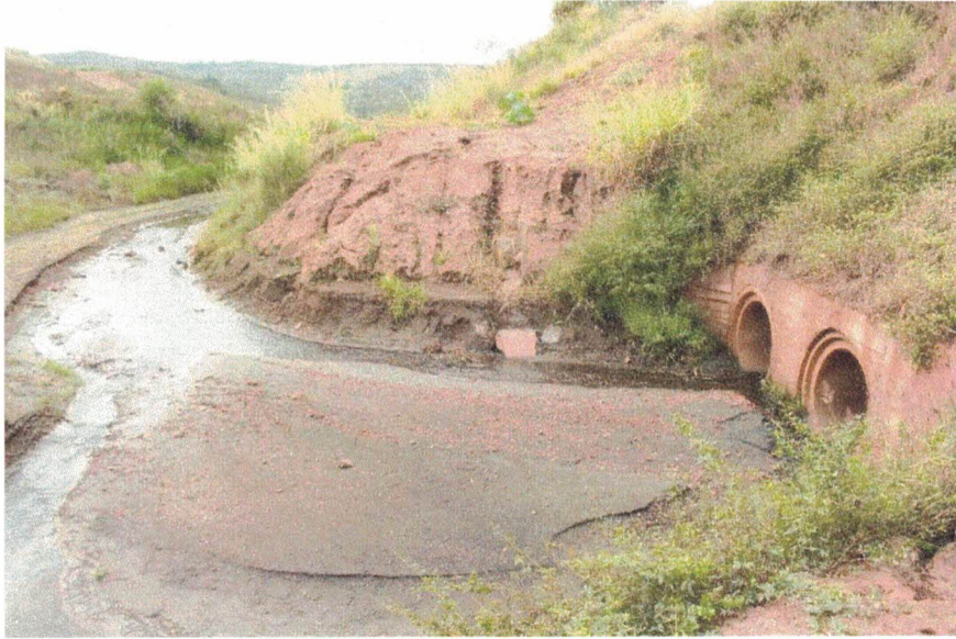
Figura 4.12 – Vista do talude próximo ao emboque do bueiro triplo do extravasor e detalhe dos sulcos erosivos do talude.
