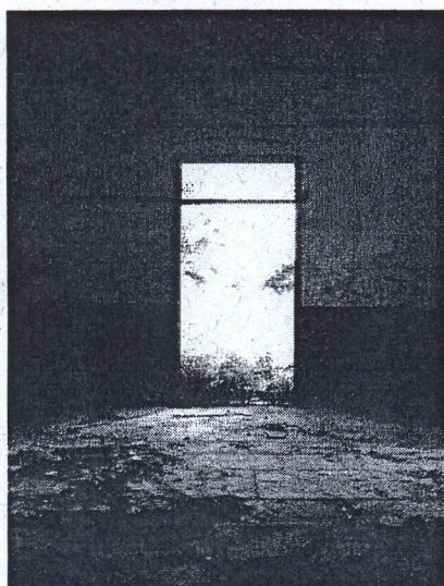
Foto 13 – Vista Interna – Sujeira e depreciação.
