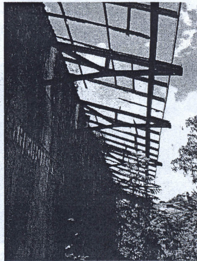
Foto 04 – Vista Lateral – Beirais em ruínas.
