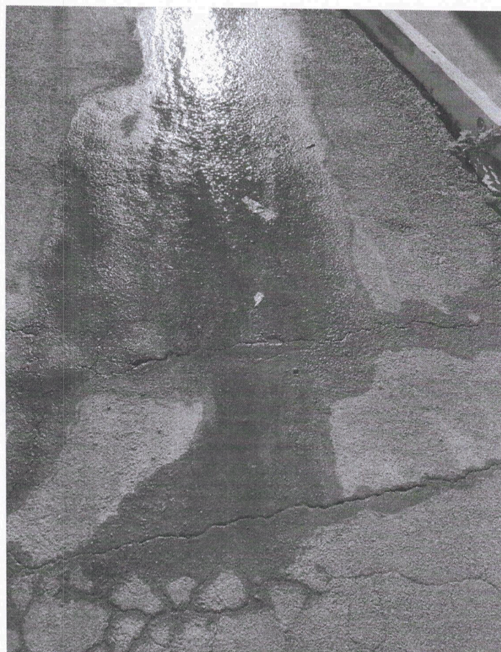
Figura 6: Visita a Rua Miguel Pacheco (Santa Rita) Para fiscalização de vazamento de água no local.
