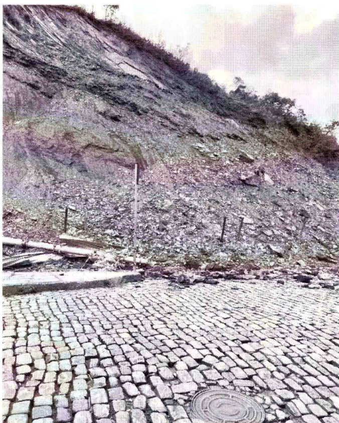
12-01-2023 - Visita ao Morro da Força para vistoria de situação do local após deslizamento.
