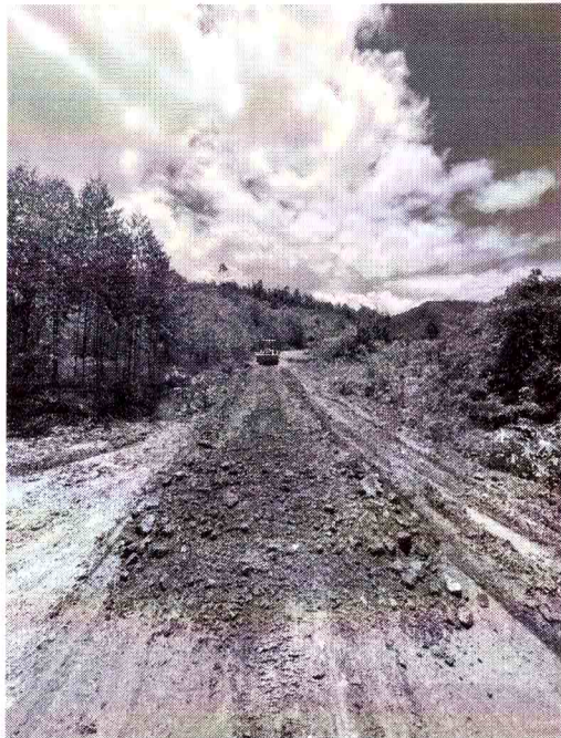
03/02/23 - Visita à localidade Bandeiras para fiscalização de serviço em execução no local.
