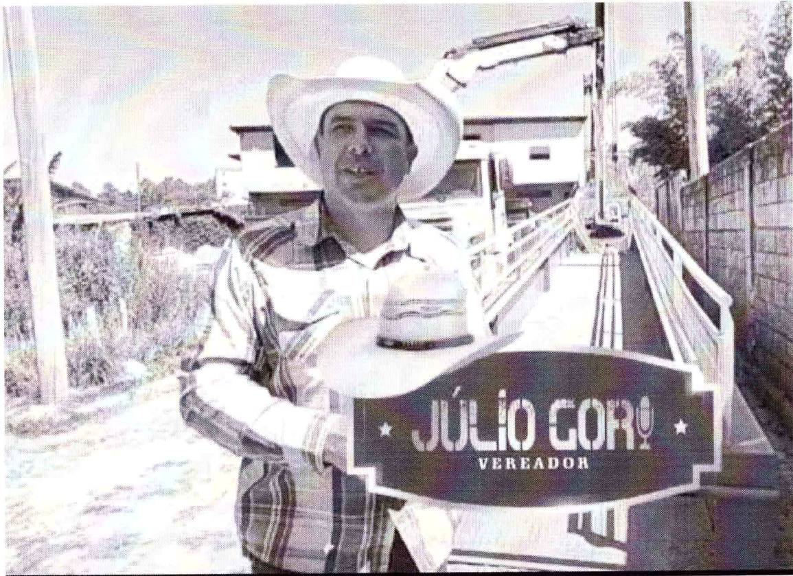
23/08/2023 - Fiscalização na finalização da obra da Passarela – Bairro do Pastinho – Cachoeira do Campo
