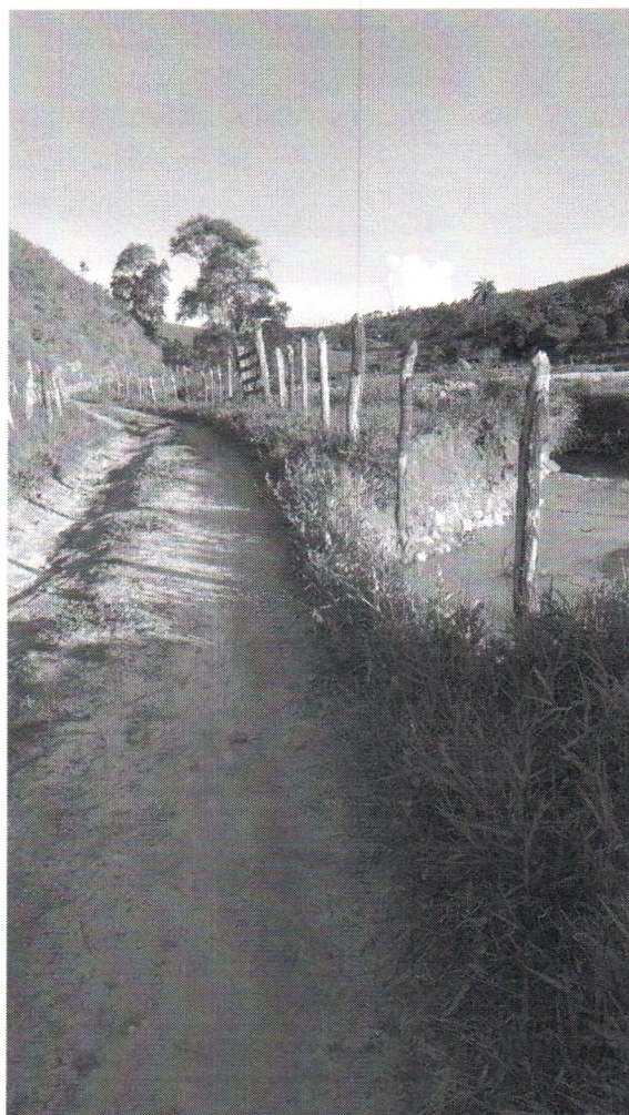
22/12/2023 - Visita ao subdistrito Bandeiras para levantamento dos estragos causados pela chuva no local.
