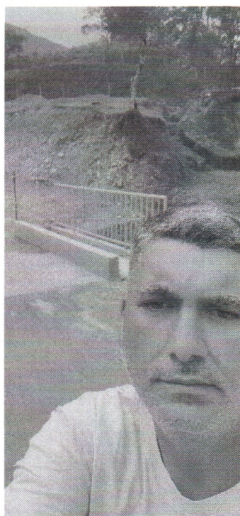
08/01/2024 - Visita ao Distrito Santo Antônio do Salto para fiscalização de obra de ponte em execução no local.
