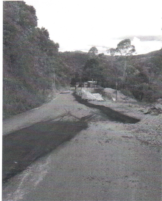
18/01/2024 - Visita ao Distrito Rodrigo Silva para fiscalização de serviço em execução na estrada que dá acesso ao local.
