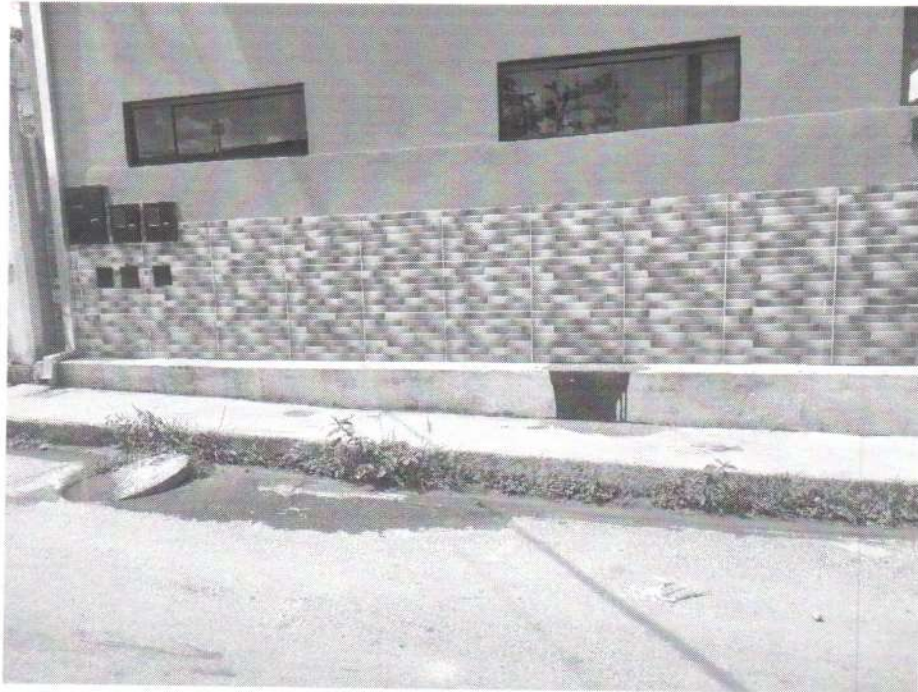
08/01/2024 – Fiscalização Rua Hum – Vazamento de esgoto.
