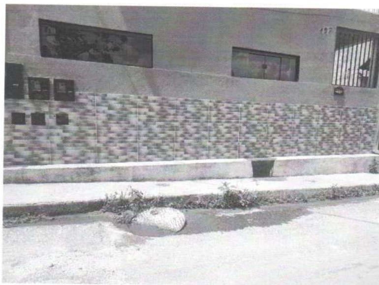
08/01/2024 – Fiscalização Rua Hum – Vazamento de esgoto
